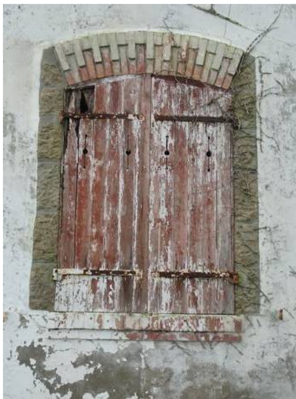
Villa Keller, 1904. 18, boulevard de la Plage. Frères Jamet. Les piédroits sont en granite, l'arc segmentaire en briques alternées ainsi que l'appui composé d'un double rang.
